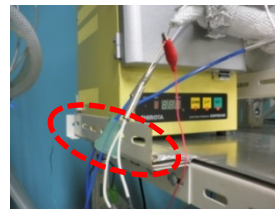
アングルの落下防止策
